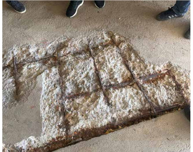
Bilden visar korroderad armering i betongplattan.
